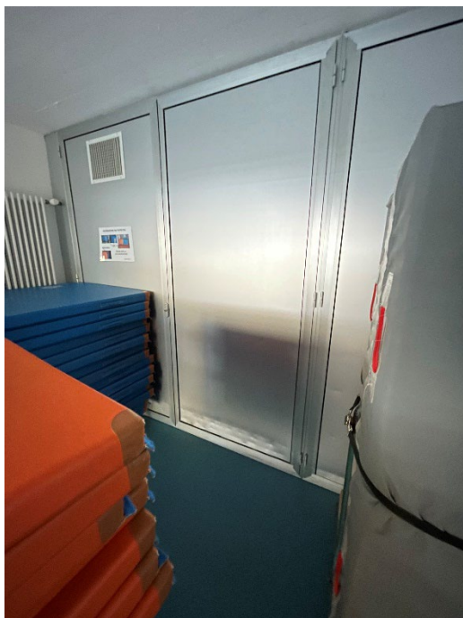
Blocco 2 palestra armadio ventilazione
