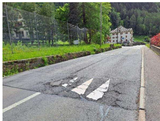
Figura 3: Dosso in cattivo stato
